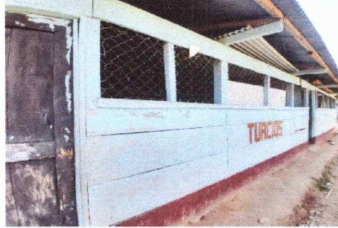
Foto 5: Pintura que se requiere sustituir.
