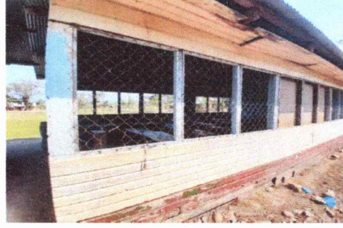
Foto 4: Entechado que se requiere sustituir del Modulo II.
