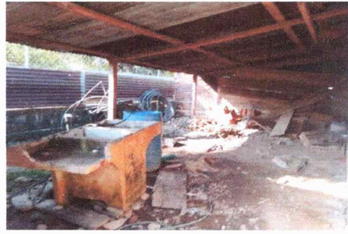
Foto 2: Galera que se necesita sustituir.
