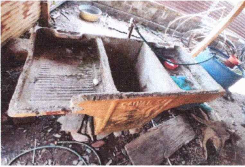
Foto 3: Pil que se requiere sustituir.
