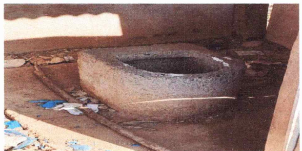
Foto 6: Se encuentra en mal estado el inodoro
